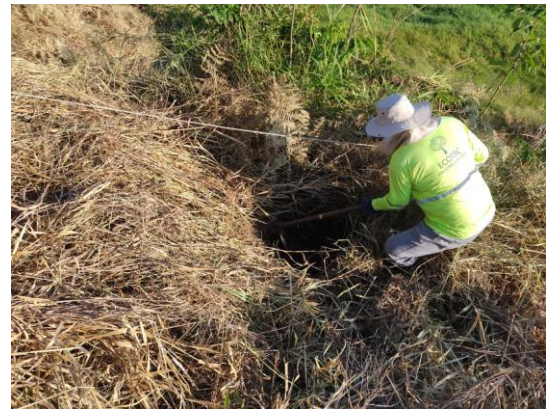
Figura 24 – Atividade de coroamento com utilização da corda para alinhamento das coroas – Fonte: Ecotec, julho. 2022.
